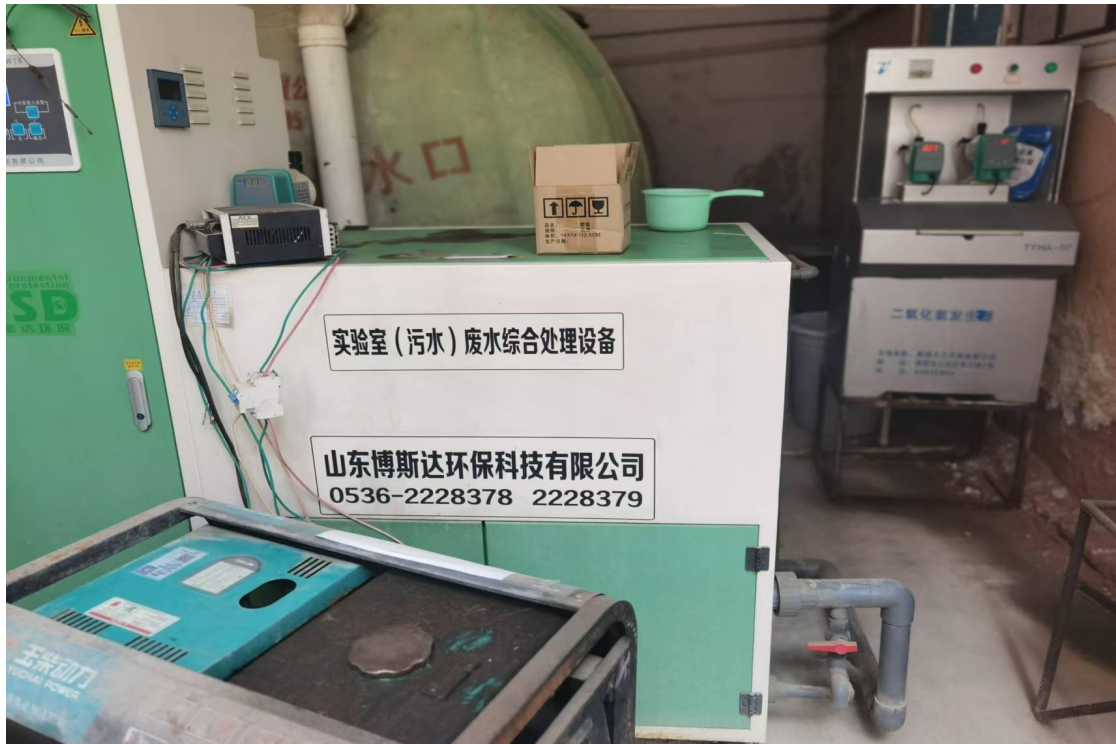
图 3.1-1 现有疾控中心污水处理设施
