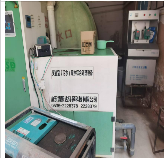
现疾控中心现行污水处理设施
